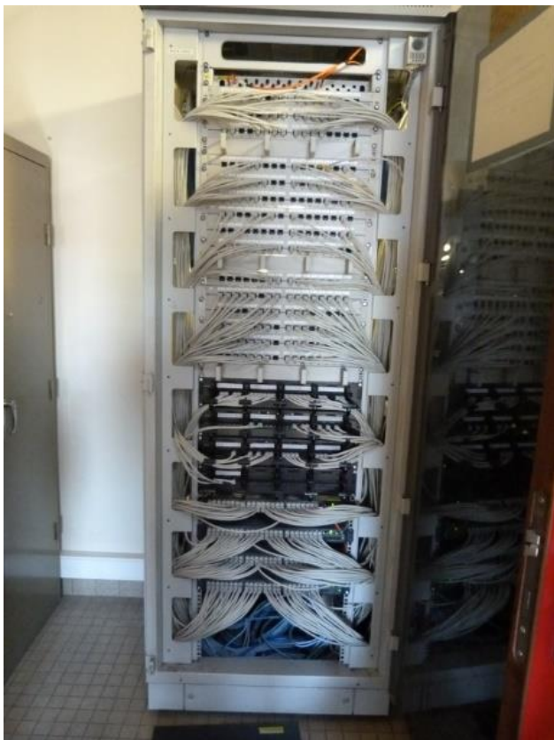
Un « patch-panel » correctement brassé
